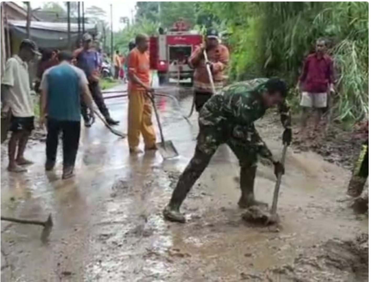
Babinsa Desa Gandusari Sertu Darkin Bersama Bhabinkamtibmas Aiptu Panji S Saat Melakukan Pengangkatan Material Longsoran Tanah di Wilayah
